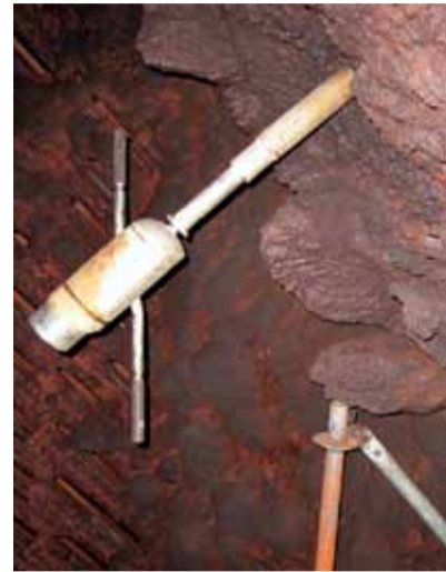
TWK im Einblasschacht positioniert
