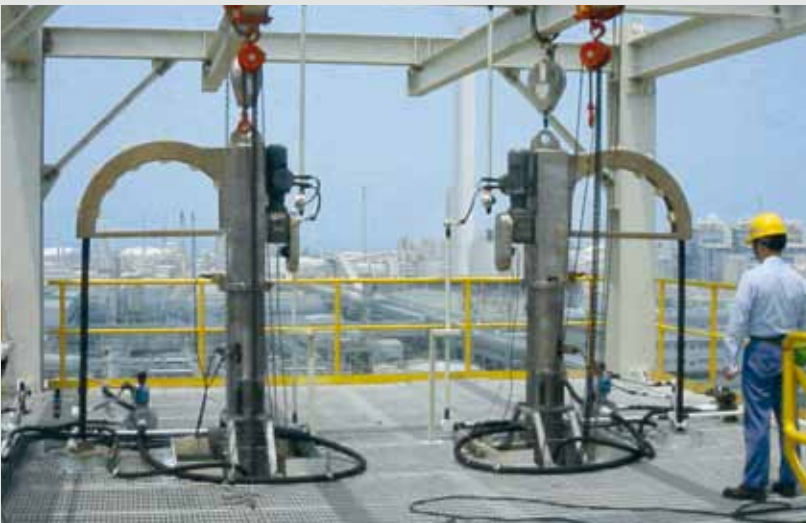
Installierte Lanzensysteme über mehrere Etagen für große Hübe
