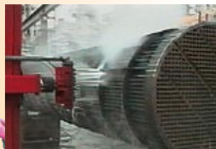
■ Автоматическая очистка теплообменников
